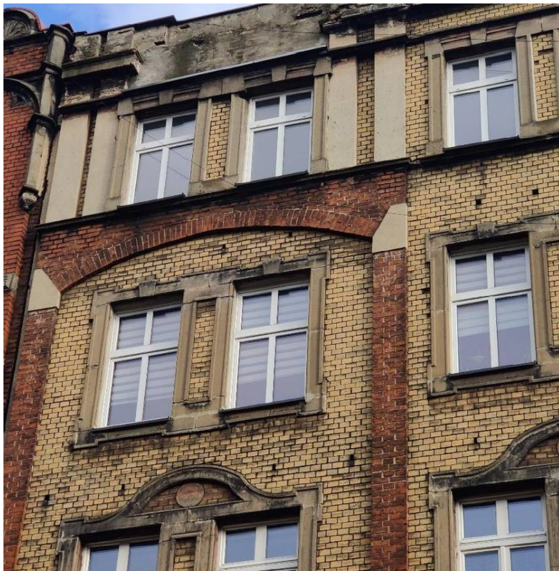
Rys. nr 11. Zabrudzenia i przebarwienia na powierzchni ścian [1.3.].
