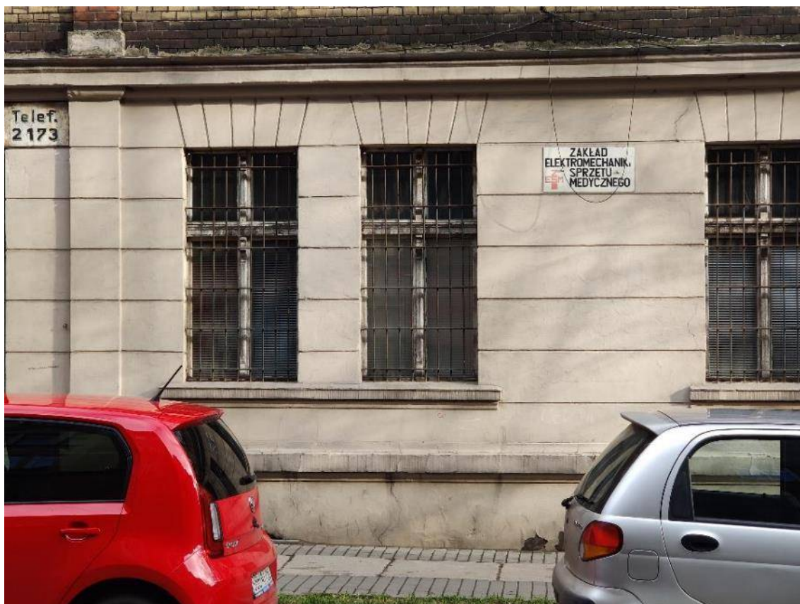
Rys. nr 14. Zabrudzenia i przebarwienia na powierzchni ścian. Spękania tynku[1.3.].
