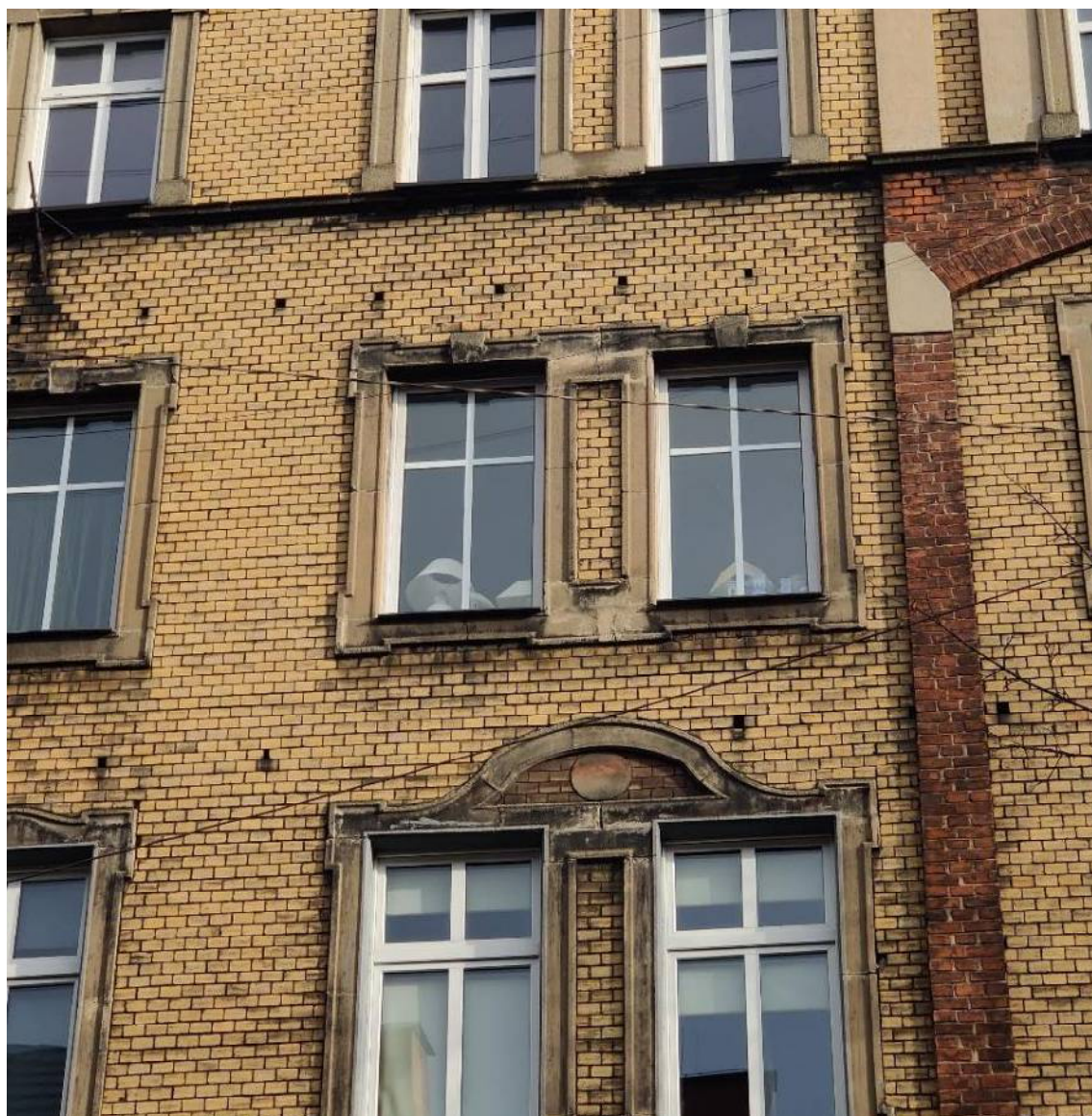
Rys. nr 17. Zabrudzenia i przebarwienia na powierzchni ścian [1.3.].
