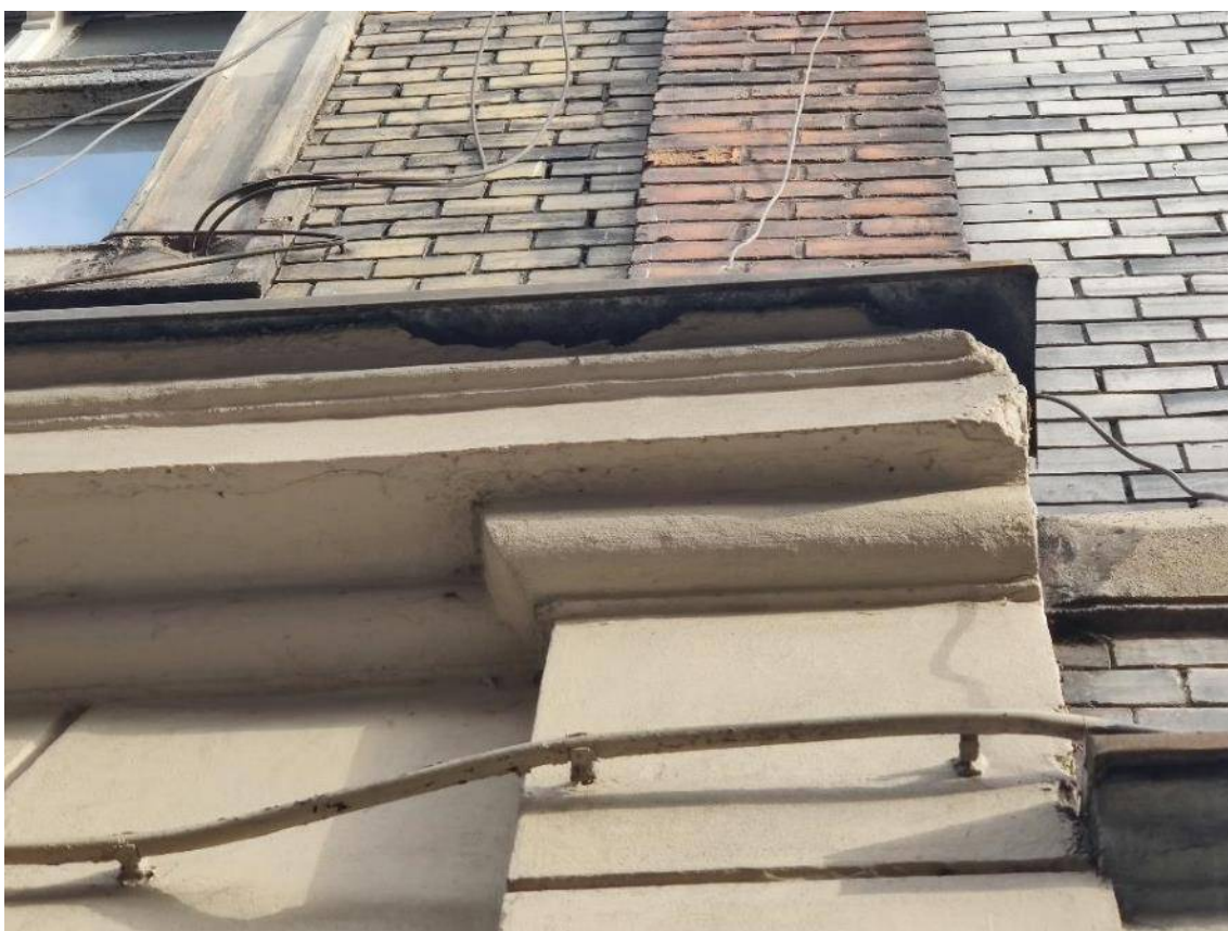
Rys. nr 8. Uszkodzenia gzymsu [1.3].
