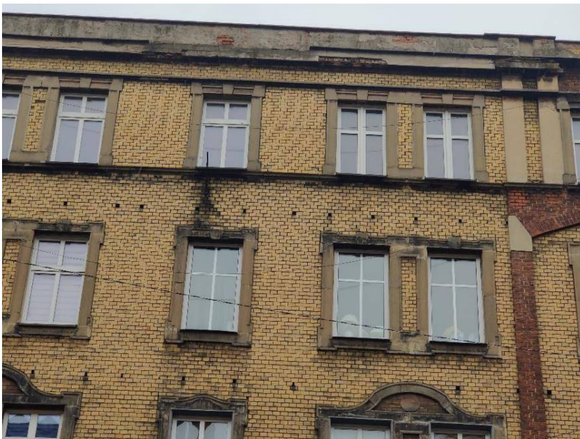
Rys. nr 5. Zabrudzenia i przebarwienia na powierzchni ścian [1.3].
