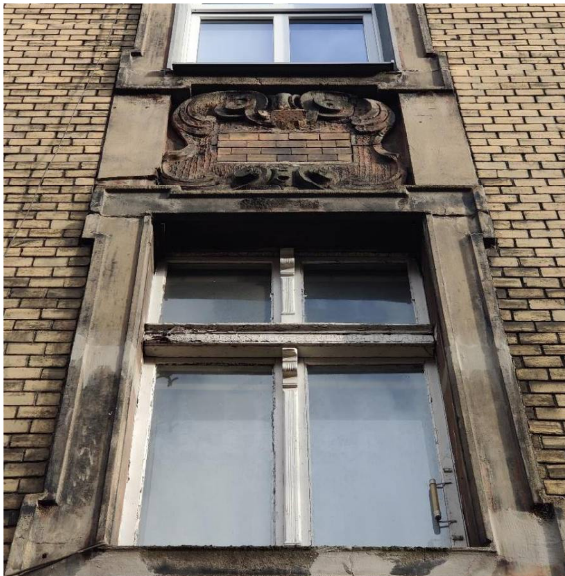
Rys. nr 9. Spękania detali architektonicznych [1.3.].
