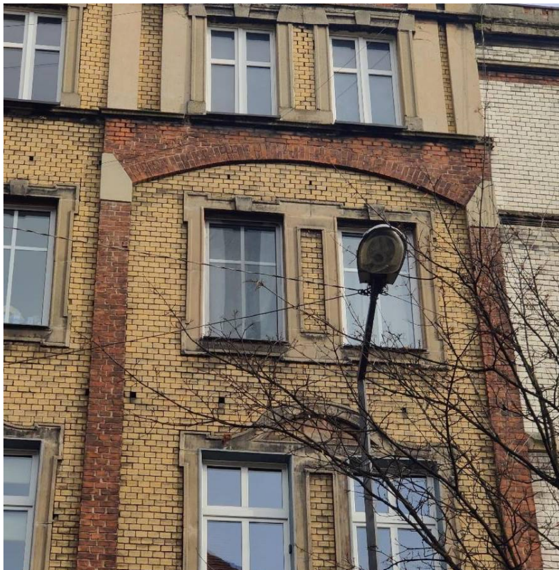
Rys. nr 16. Zabrudzenia i przebarwienia na powierzchni ścian [1.3.].
