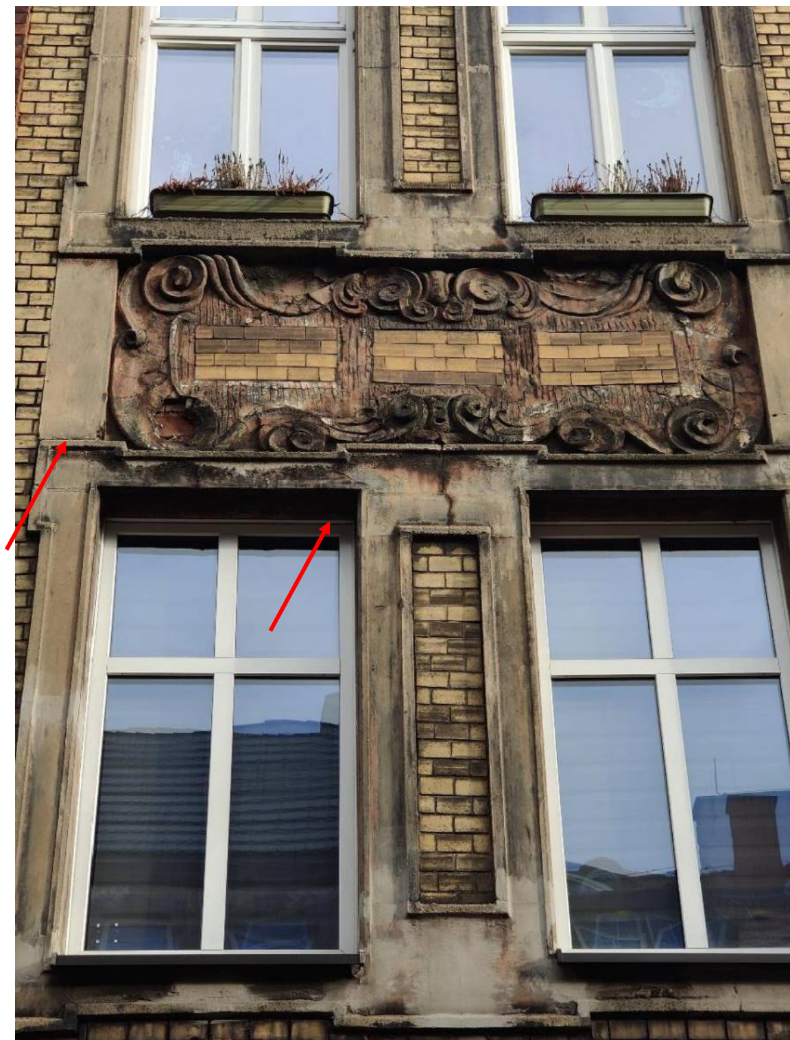
Rys. nr 10. Spękania i uszkodzenia detali architektonicznych [1.3].
