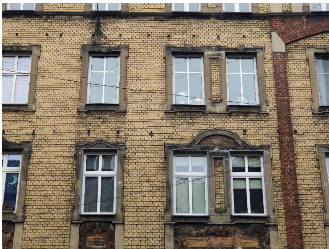
Rys. nr 3,4. Zabrudzenia i przebarwienia na powierzchni ścian [1.3].
