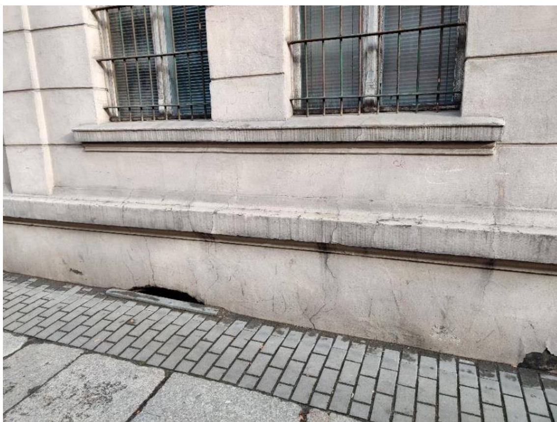
Rys. nr 12,13. Zabrudzenia i przebarwienia na powierzchni ścian. Lokalne zawilgocenia ściany cokołowej, odparzenia tynku [1.3].
