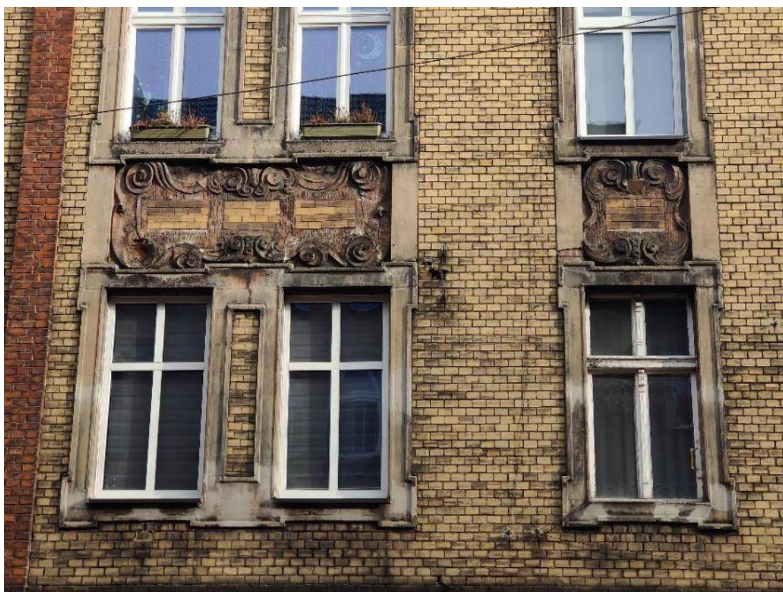
Rys. nr 15. Zabrudzenia i przebarwienia na powierzchni ścian [1.3.].
