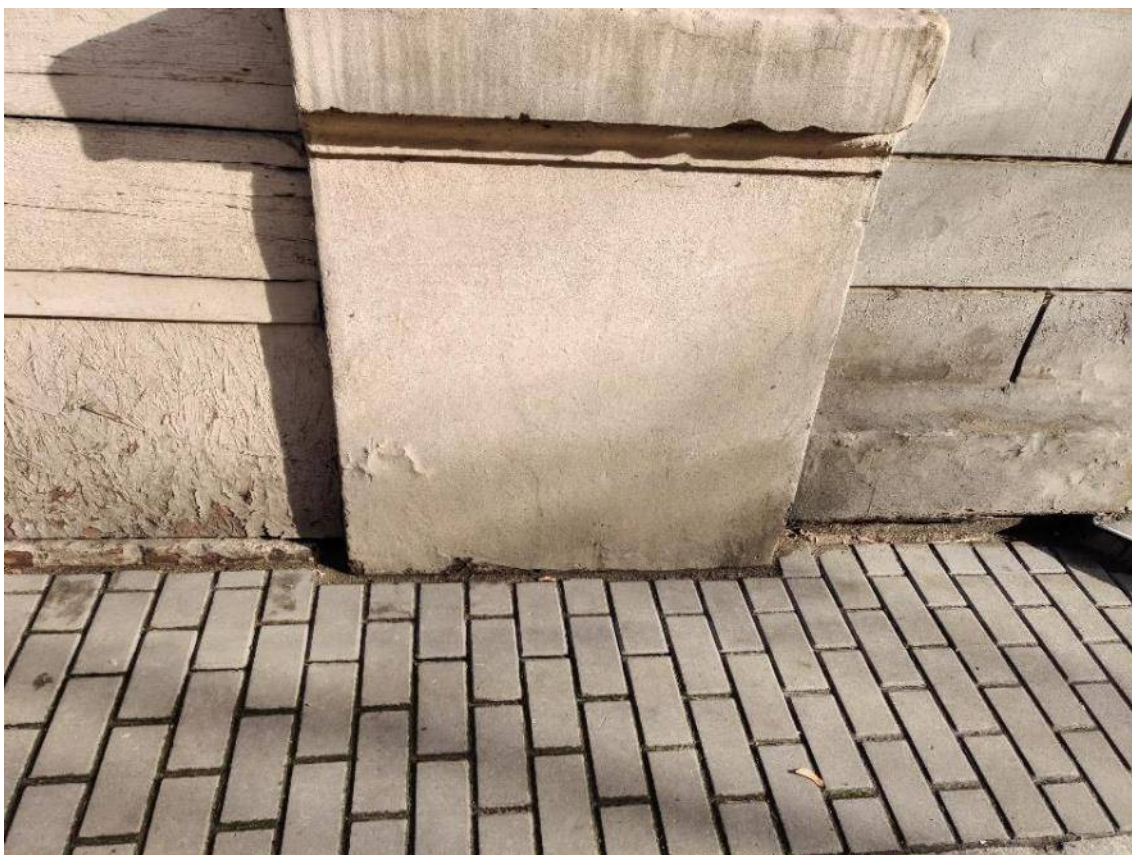
Rys. nr 6. Zabrudzenia i przebarwienia na powierzchni ścian. Lokalne zawilgocenia ściany cokołowej [1.3].
