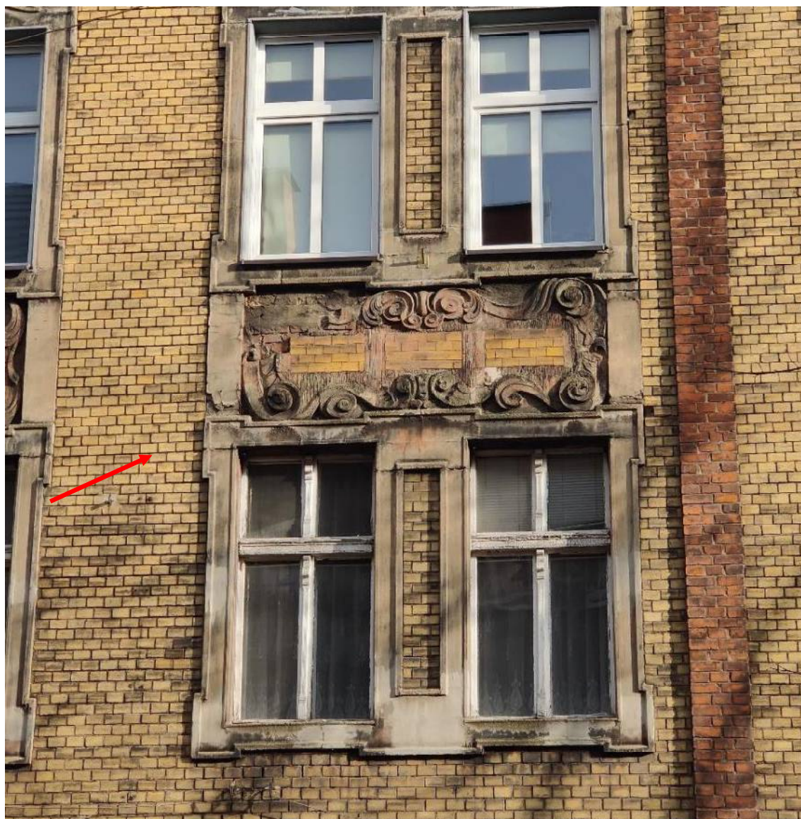
Rys. nr 18. Zabrudzenia i przebarwienia na powierzchni ścian [1.3].
